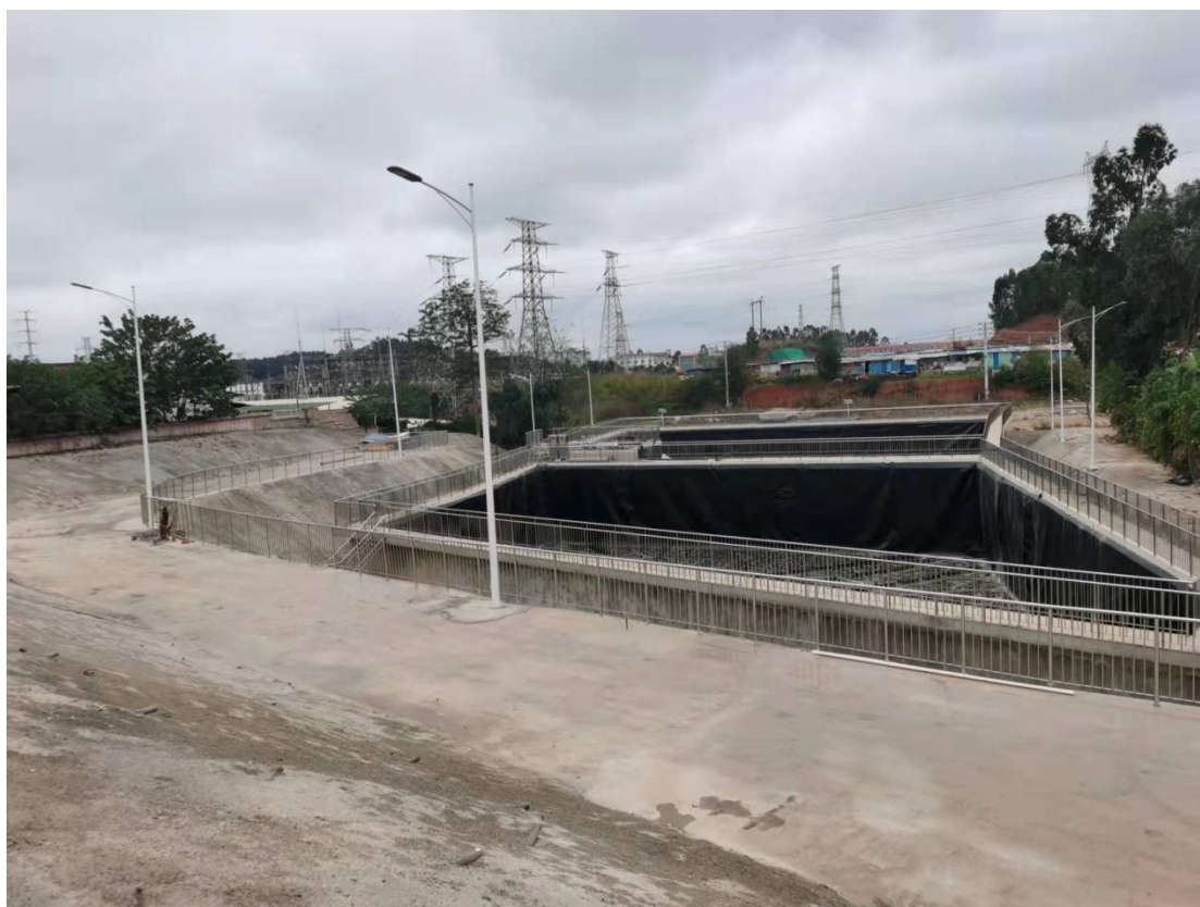
厂区事故应急池
